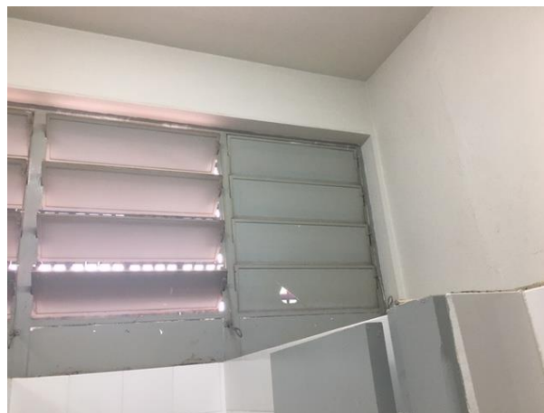
Vidros danificados (banheiro feminino)
